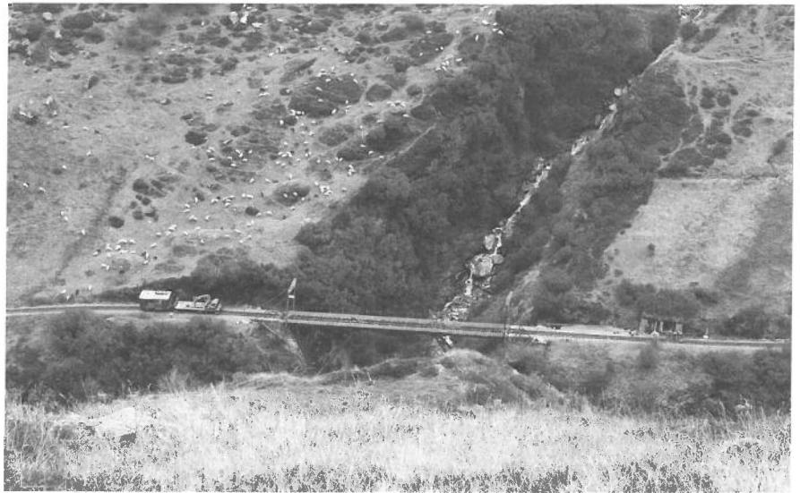
Steffenbachbrücke, Vorarbeiten für die Demontage. Pont du Steffenbach, préparatifs pour le démontage.
