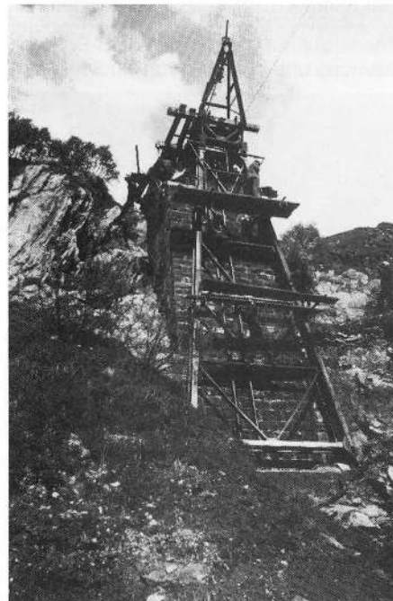
Die bergseitige Schrägstütze musste gerichtet und verstärkt werden.
