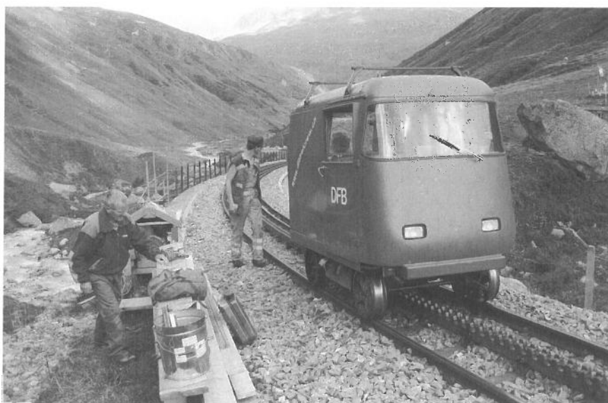
Stefan holt mit der «Erdbeere» (Dieselfahrzeug) die Fronis am Steinstafelviadukt ab Stefan récupère les bénévoles au viaduc de Steinstafel avec la «fraise» (vhc diesel)
