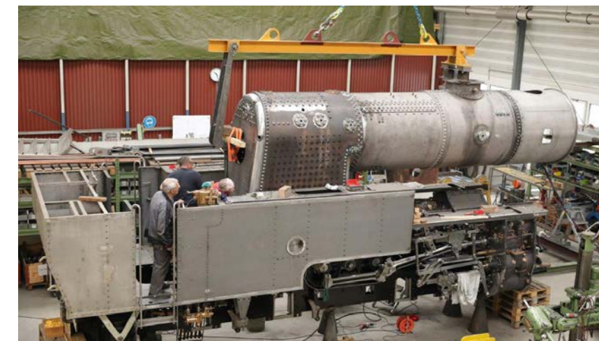
Der Kessel wird zur Überprüfung und Regulierung der Befestigung- und Auflagepunkte erstmals auf den Rahmen gehoben.
