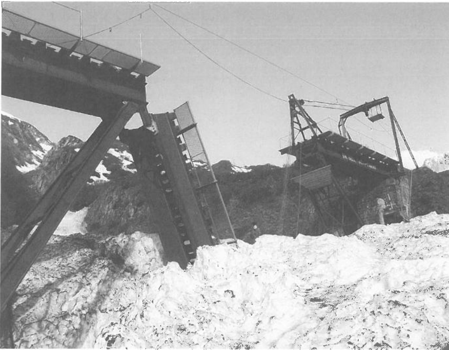
Der Brückenmittelteil kann wegen des Lawinenschnees nicht hochgezogen werden. La partie médiane du pont ne peut pas être levée en raison de la neige d'avalanche.
