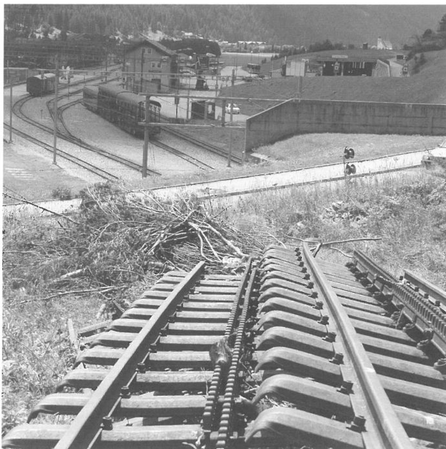
Blick vom derzeitigen (vorläufigen) Ende der Bergstrecke auf den Bahnhof Oberwald der MGB.
