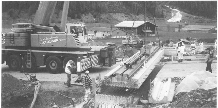
Die absenkbare Zahnstang wird eingesetzt (Foto: R. Tobler) Mise en place du passage à niveau
