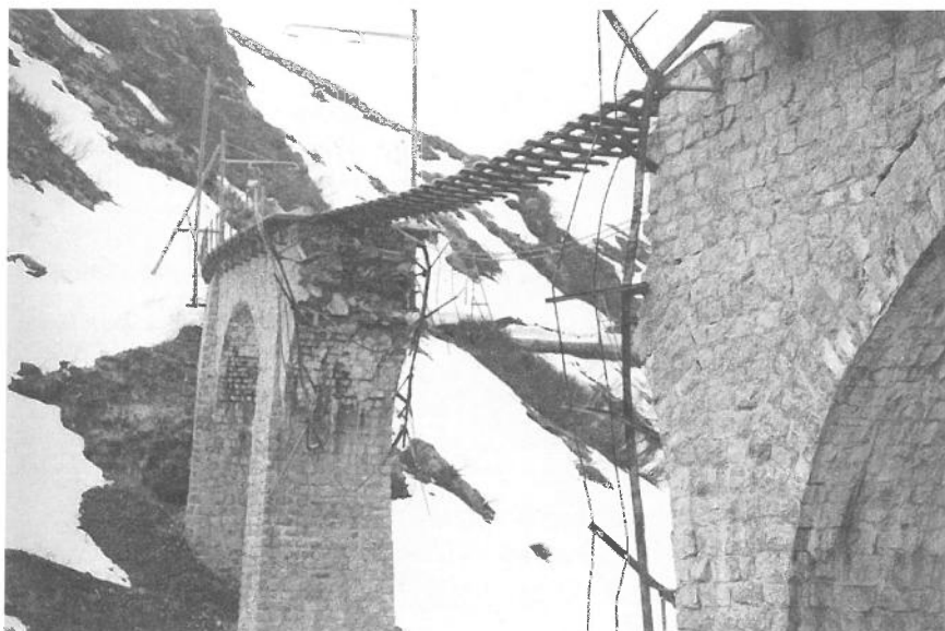
Schmelzwasser unterspülte am 10.05.1955 einen der vier Pfeiler des Furkareuss-Viadukts II, der sogenannten Wilerbrücke, und brachte das Bauwerk zum Einsturz. le 10.5.1955, l'eau de fonte a sapé les fondations d'un des piliers du viaduc de la Furkareuss II, aussi nommé pont de Wiler, et a fait s'effondrer l'ouvrage d'art.
