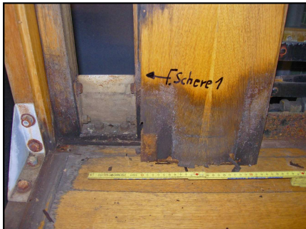
Wasser hat dem Holz arg zugesetzt
