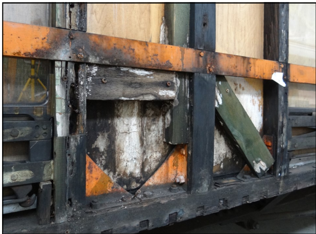
Massive Witterungsschäden verbargen sich hinter der Blechhaut
