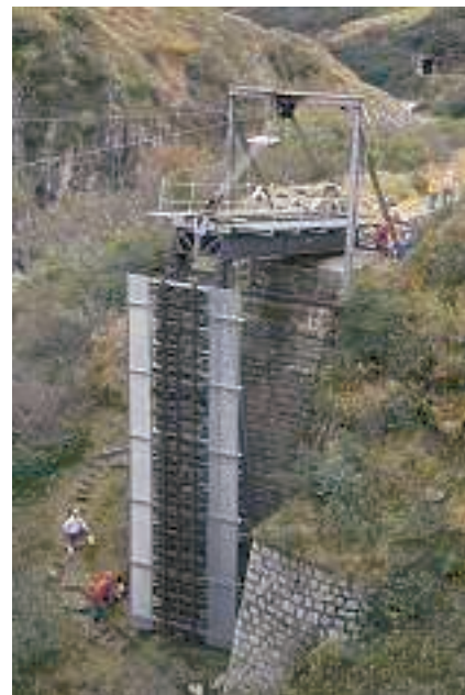
Rückzug des unteren Brückenteils mit angehängtem Mittelteil. / Retrait de l'élément inférieur avec la partie médiane suspendue.
