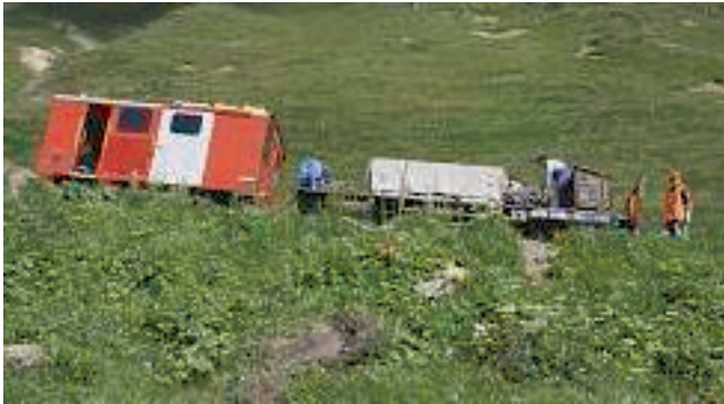
Mit viel Wasser und viel Druck wurde ein Wasserdurchlass durchgespült und ist damit wieder funktionsfähig. / Le ponceau a été dégagé avec beaucoup d'eau sous haute pression.
