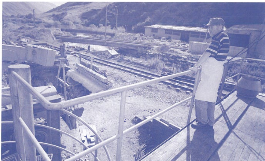
Der Traum geht in Erfüllung: die Bauarbeiten für den neuen Küchentrakt in Realp haben begonnen.
