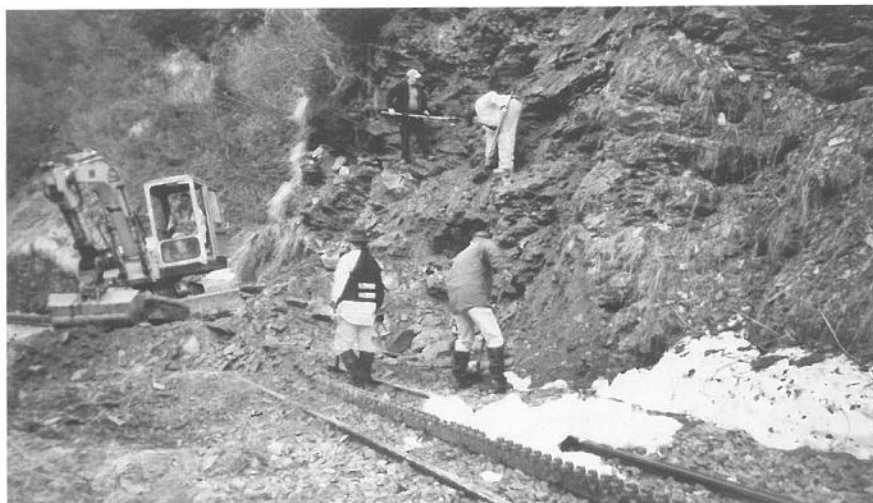
Das Erdbeben-Material muss vom Gleis weggeräumt werden. Evacuation des éboulis.
