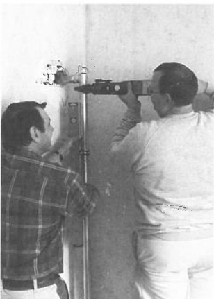
Wasserinstallationen im Blauen Haus.
