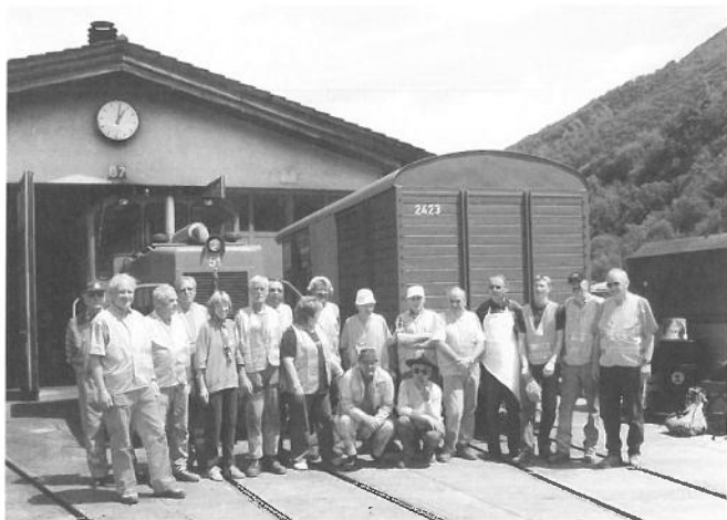
Baugruppe der VFB Sektion Zürich vor dem Depot Realp. Beginn der Verlegearbeiten, Aushub- und Planierarbeiten. Groupe de travail de la section Zurich ALSF devant le dépôt de Realp. Début des travaux de pose, de fouilles et de terrassements.
