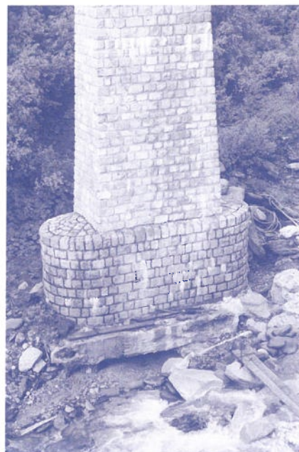
Die Unterspülung eines Pfeilers der Wilerbrücke ist auf unserem Bild gut zu sehen. Sie ist inzwischen behoben.
