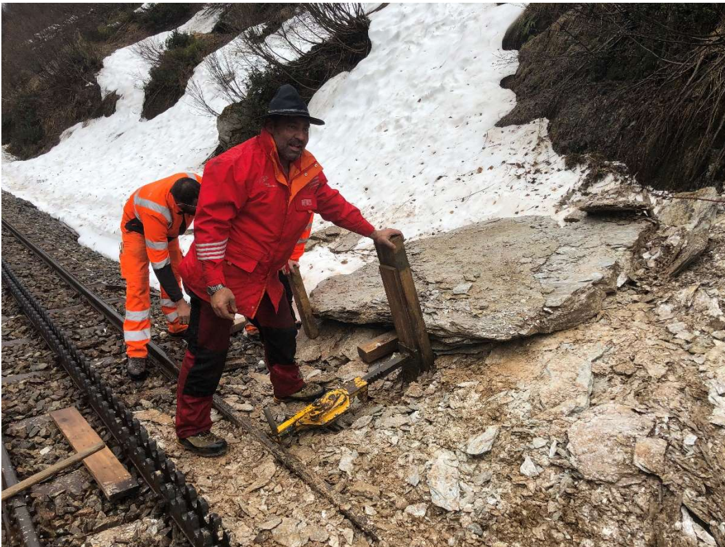
Nach 1 Stunde kann die HGm 51 die Stelle knapp passieren. Die Felspartie oberhalb der Absturzstelle muss vor Beginn der Betriebssaison geräumt und gesichert werden. Sonst drohen weitere Steinschläge. Bild: Patrick Smit.
