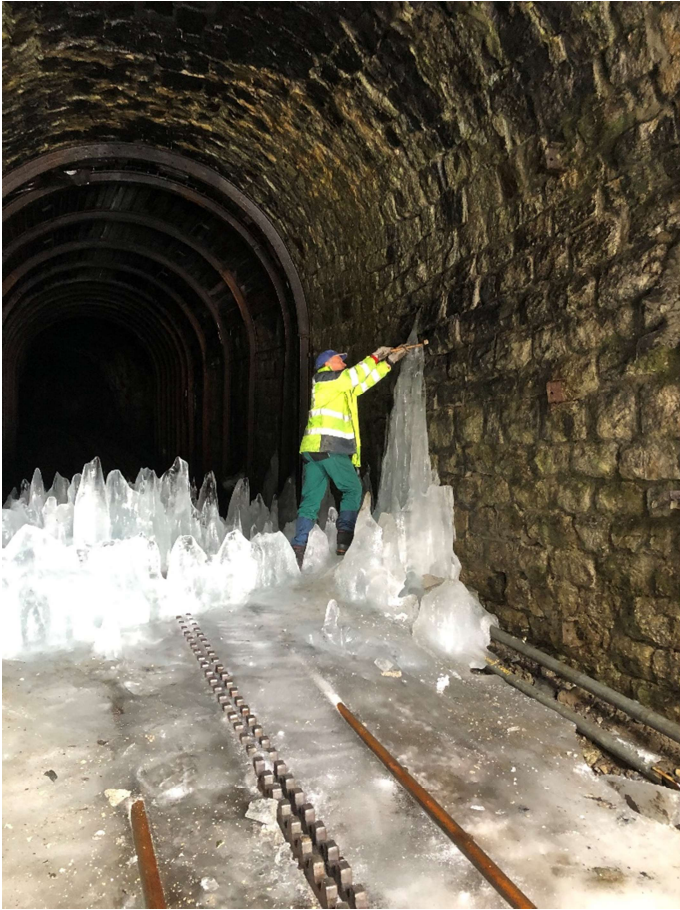
Hinter dem talseitigen Tor des Tunnels 2 hat das Bergwasser gewaltige Stalagmiten gebildet. Bild: Karlheinz Felder.
