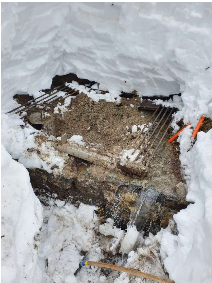
Unter einer 2 m mächtigen Schneedecke findet das Schneeräumungsteam die Wasserfassung der Station Tiefenbach. Während dem Unwetter vom Oktober 2020 wurde diese komplett mit Geschiebe gefüllt. Bild: Michael Bühler.
