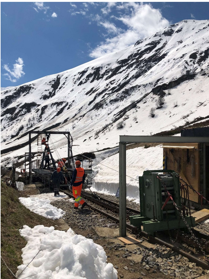
Blick von der hydraulischen Winde vor dem Windenhaus zum oberen Brückenelement. Bild: Karlheinz Felder.
