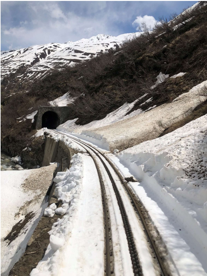
Mit der Schneeschmelze werden Felsbrocken freigelegt, die mit der Lawine oder Schneerutsch mitgerissen wurden. Diese müssen jeweils vom Bahntrasse geräumt werden. Bild: Karlheinz Felder.
