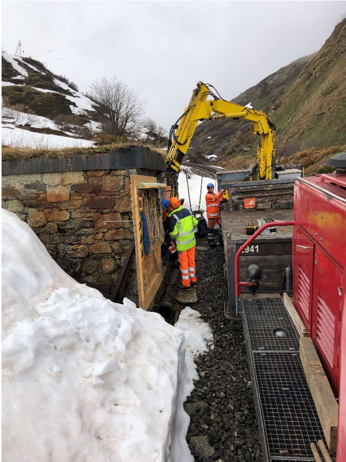
Die Seilhaken der Steffenbachbrücke werden im Windenhaus deponiert. Bild: Patrick Smit.
