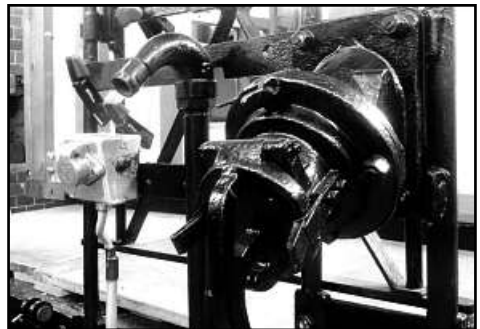
Stecker für die Leitungen der Lichtsteuerung und die Lautsprecheranlage (links) und die robuste Steckverbindung für die 300 Volt Durchgangsleitung (rechts).
