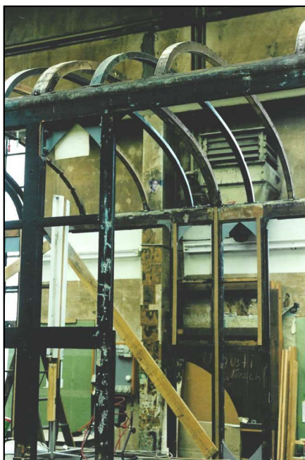
Ohne das (verrottete) Dach ähnelt der Wagen einem Skelett
