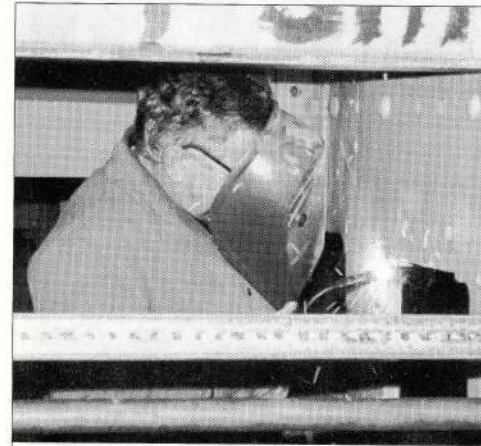
Riss-Schweissen in der Achslageröffnung
