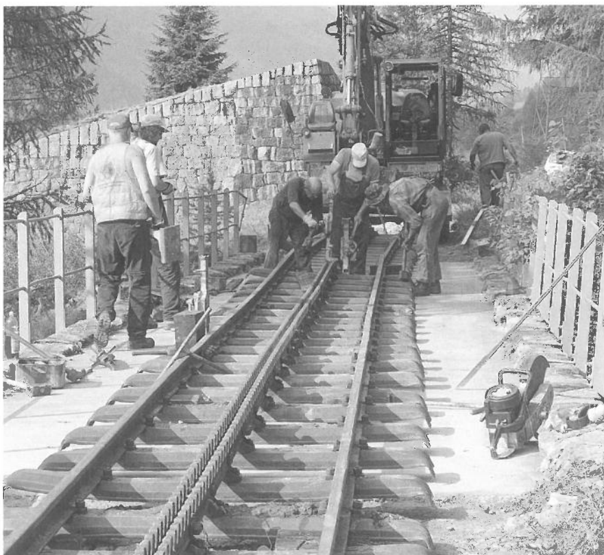
Wiedereinbau der Gleisjoche im Bereich der «Räterisbrücke». Mise en place des coupons de rails près du Rätischbach.
