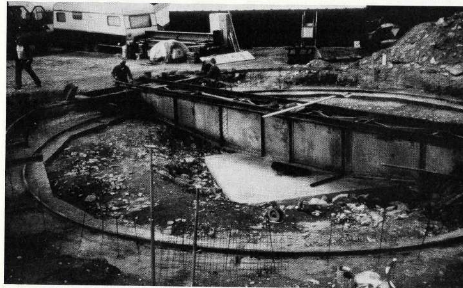
Bereits ist die Drehscheibe vor dem zukünftigen Lokdepot in Realp eingebaut. Bereits hat sie auch schon ihre Funktionstüchtigkeit im Einsatz bewiesen. Et voilà la plaque tournante de nouveau en place devant le futur dépôt des locos à Realp. Elle a déjà servi et prouvé son bon fonctionnement.
