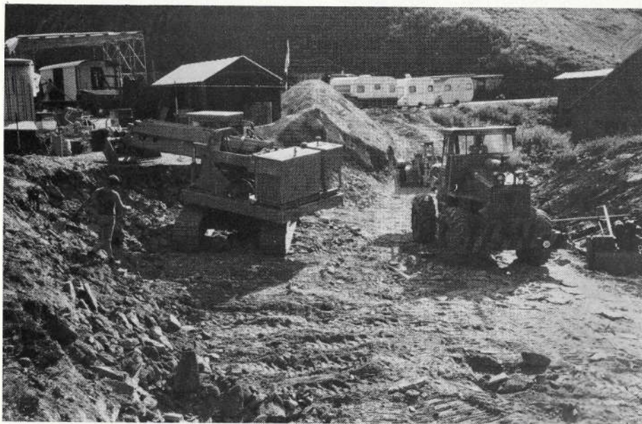
Nach Eintreffen der sehnsüchtig erwarteten Baubewilligung konnte auch die Arbeit für die Errichtung des Lokdepots in Realp aufgenommen werden. Le permis de construction impatientement attendu étant enfin arrivé, l'édification du dépôt de locomotives à Realp a pu commencer.
