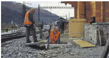
Marcel Pflüger und Bruno Berto ziehen Kabel ins neue Dienstgebäude Oberwald / Marcel Pflüger et Bruno Berto tirent des câbles vers le nouveau bâtiment de service à Oberwald
