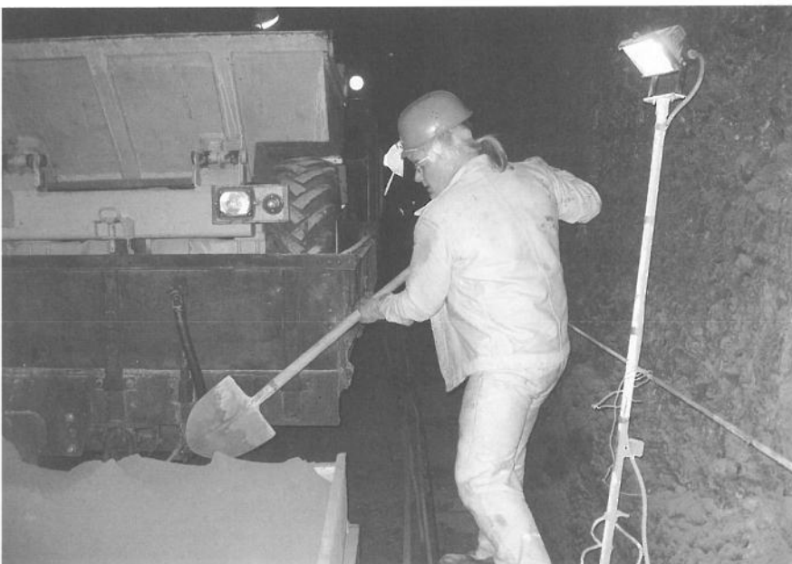
Herbert Hartz bei der Arbeit im Scheiteltunnel. Herbert Hartz au travail dans le tunnel sommital.
