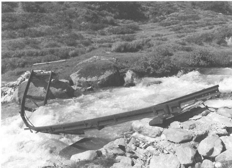
Die von Lawinen des Winters 2006 zerstörte Brücke. Le pont détruit par des avalanches en 2006...
