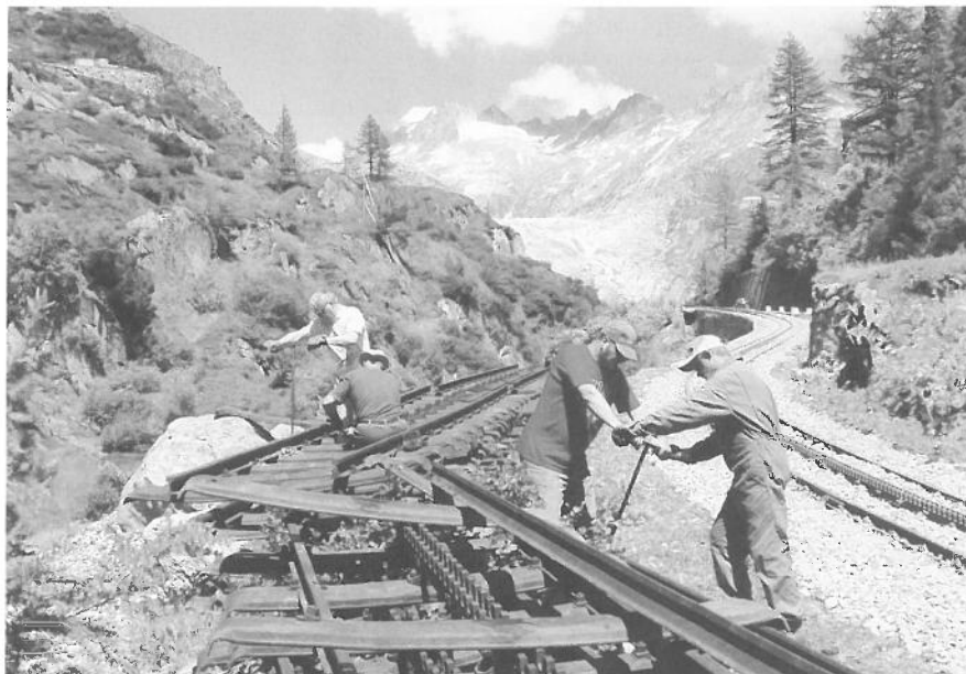
Opération de nettoyage de chantiers par les sections Belgique et Romande: démontage de coupons de rails en dessous de Gletsch.
