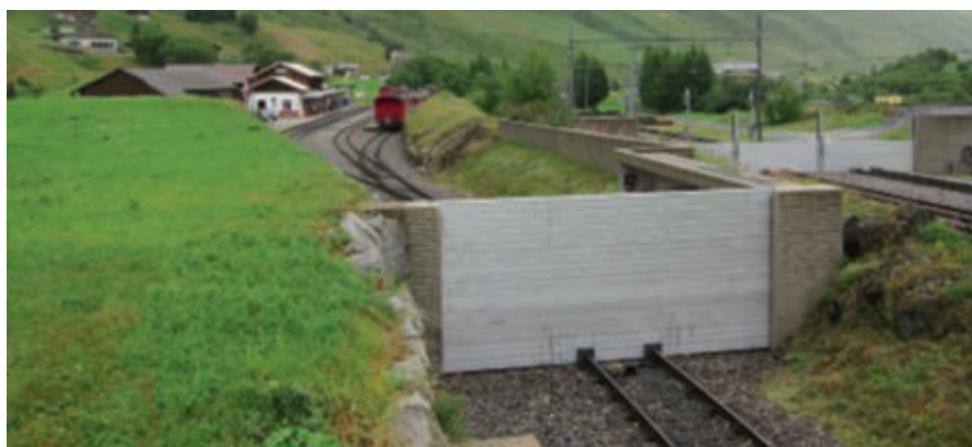
Oberhalb unserer Station wurde eine Schutzwand montiert / Un mur de protection a été érigé en amont de notre station
