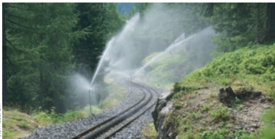
Die BLA in Betrieb (unterhalb Wasserfassung I) / Installation d'arrosage et d'extinction en service (en aval du captage I)
