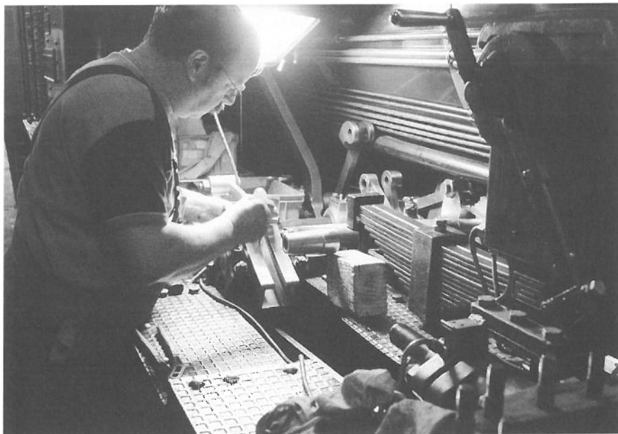
Bei der Lok 6 werden Betätigung der Schieber und deren Dichtflächen überholt. Révision des commandes des tiroirs et de leurs surfaces étanches de la loc 6.
