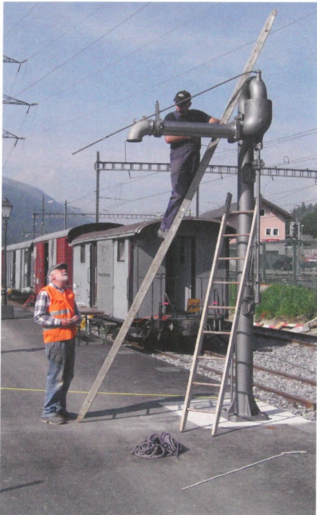
Aufbau Wasserkran in Oberwald Construction de la grue à eau à Oberwald (Foto Markus Staubli)
