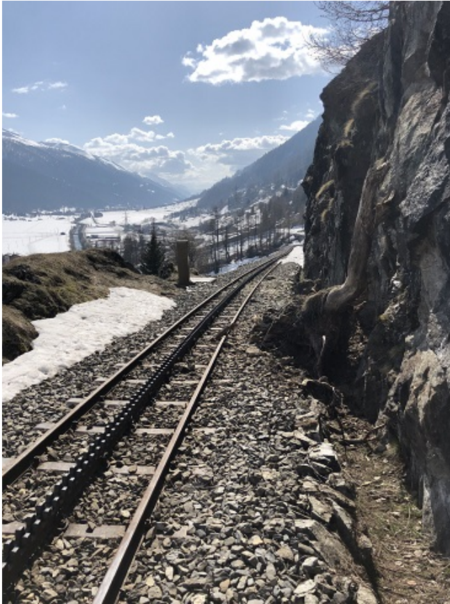
Bahnstrecke bei km 42.3, ca. 300 m oberhalb der Räterisbachbrücke. Ein Baumstrunk ist vom Felsband auf den Bahnkörper gestürzt.
