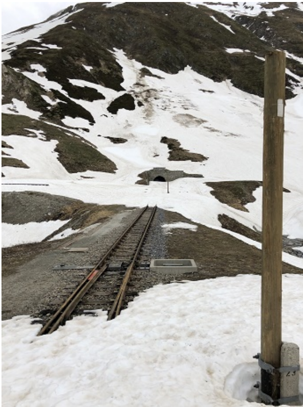
Die Einfahrweiche Seite Scheiteltunnel der Station Muttbach-Belvédère.
