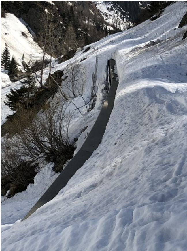
Das Lehnenviadukt Mässweid bei km 44.4. Eine Lawine hat die Lehrgerüste demoliert.
