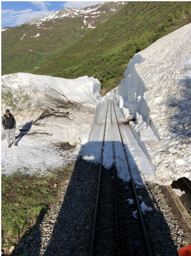
Der 6 m hohe Lawinenkegel zwischen Tunnel 2 und Tunnel 1 ist nach einem Tag endlich bezwungen.
